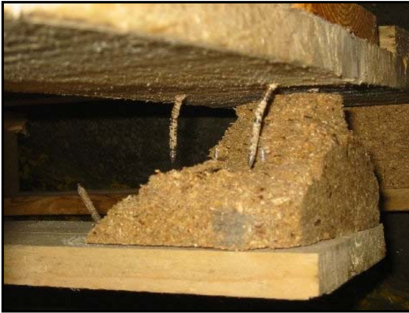
Abb. 2: Nicht tauschfähig: Teilweise herausgebrochener Klotz mit frei herausstehenden Nägeln
